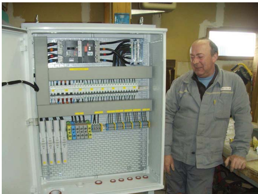
armoire électrique pour l'alimentation d'un chantier de gros œuvre
